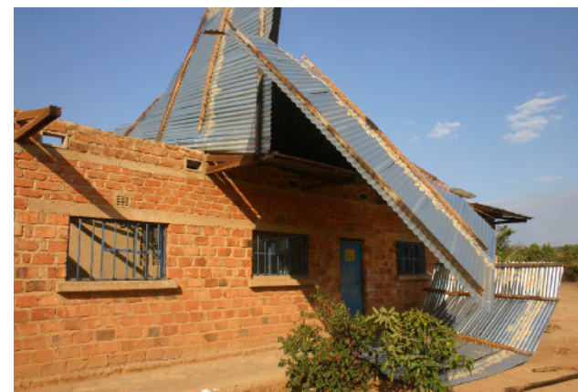
Während der Ferien riss eine Windböe das Dach von „unserer“ Schule. Seitdem versucht IAFTA, die Lehrer bei der Sanierung der Finanzen und Gebäude zu unterstützen.
